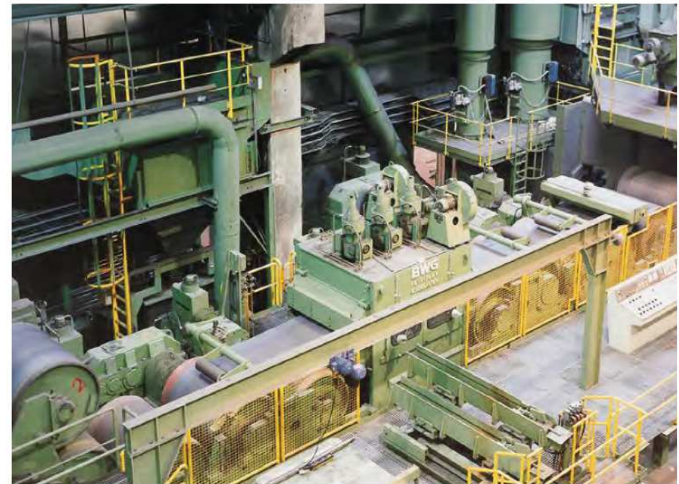
Instalações de estiramento, dobra e retirada de crosta Scalemaster® numa linha de decapagem para aço inoxidável
