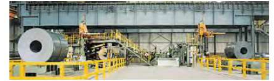
Lado de entrada grupo de desbobinamento
